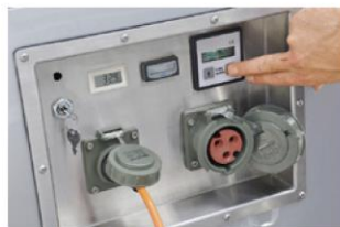
Schaltzentrale mit Anschlüssen und Displays.
